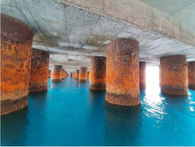
Şekil 1. Korozyona uğramış deniz yapılarına örnek (Save Teknoloji, 2022)
