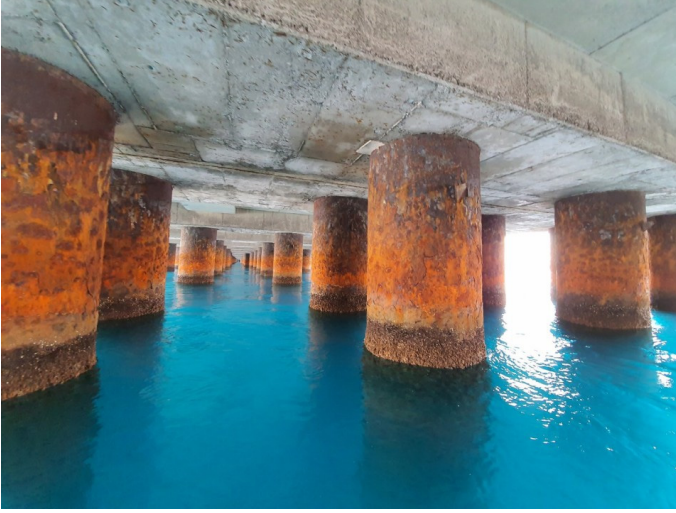
Şekil 1. Korozyona uğramış deniz yapılarına örnek (Save Teknoloji, 2022)
